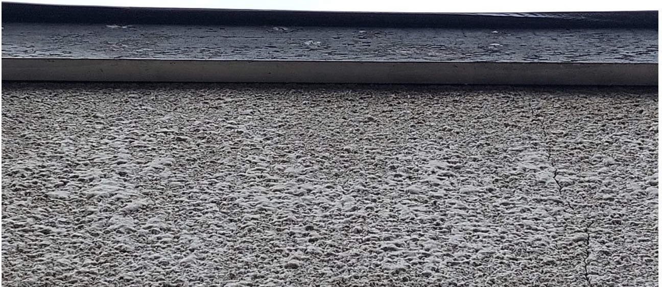
Figuur 4.4.4. Tussen het boeiboord en gevel is geen ruimte voor vleermuizen.
