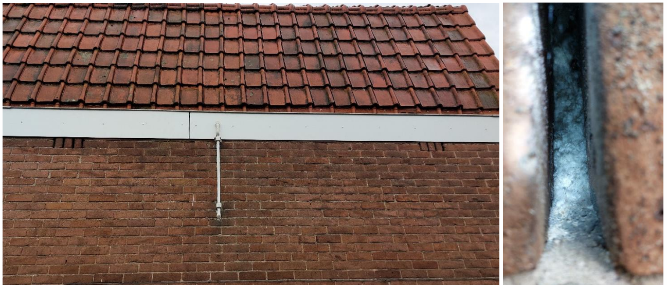
Figuur 4.4.5. In de ventilatiesleuven in de gevel van Nispensestraat 78 (l) bevindt zich overal isolatiewol (r). Tussen het boeiboord en de gevel is daarnaast geen ruimte voor vleermuizen.
