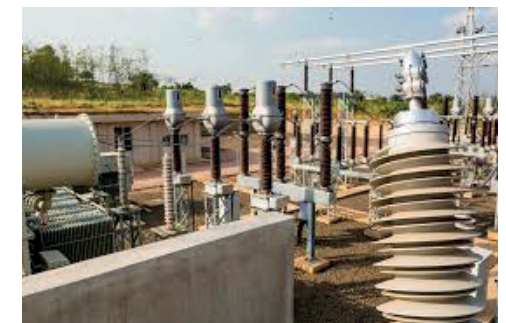
Aanlanding 2e aansluiting Roosendaal op hoofdnet elektriciteit
