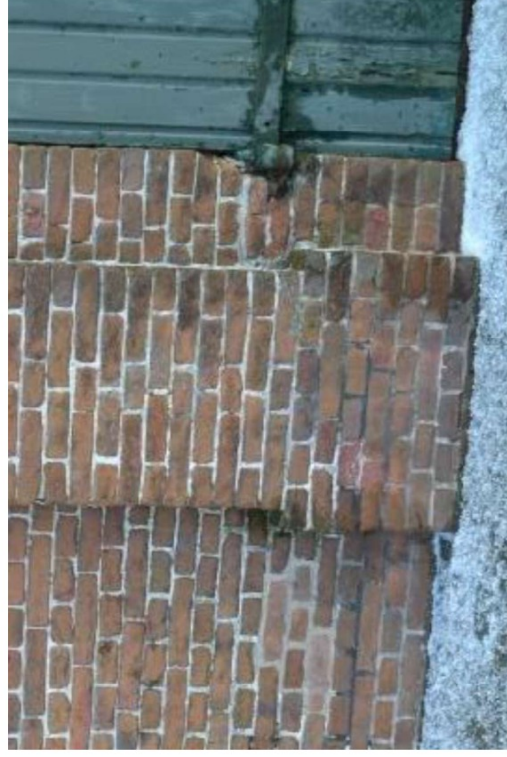
Kleine verbreding aan onderzijde gemetselde pilaters.
