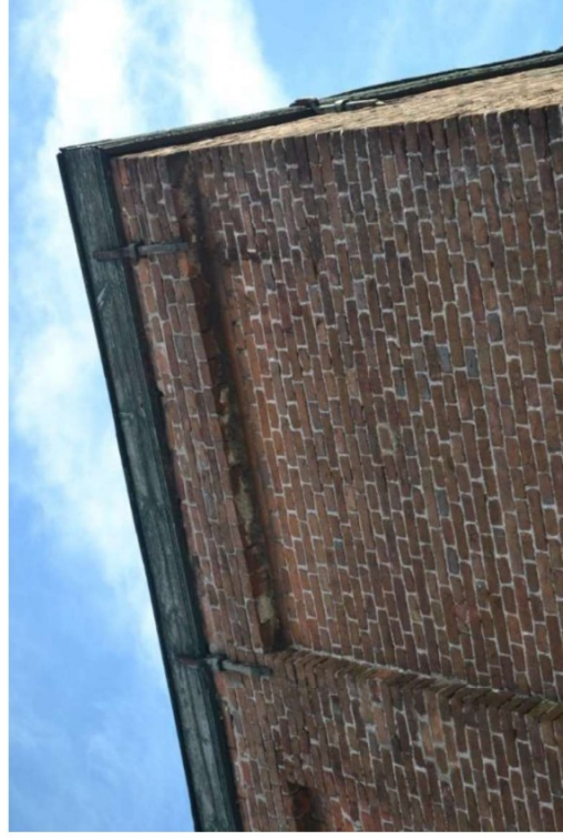
Houten boeiboord en gevelankers.
