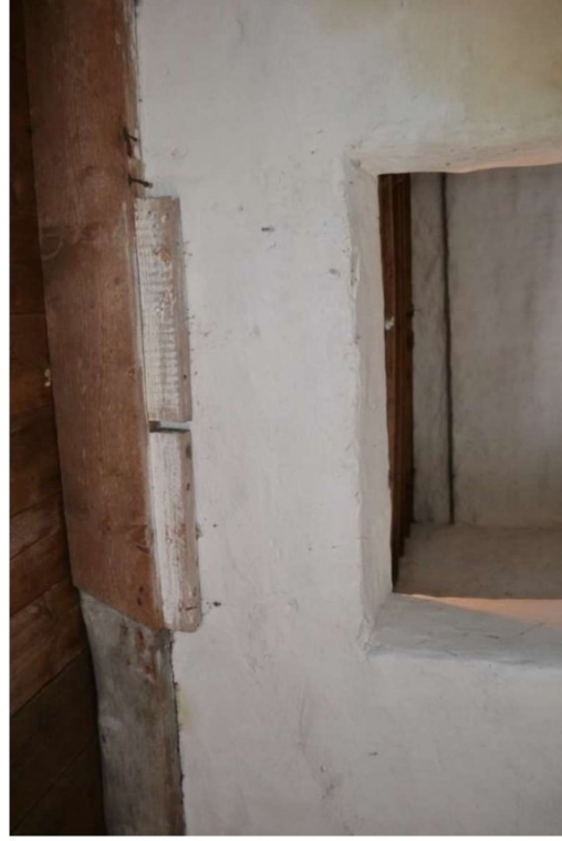
Later aangebrachte doorbraak in tussenmuur.
