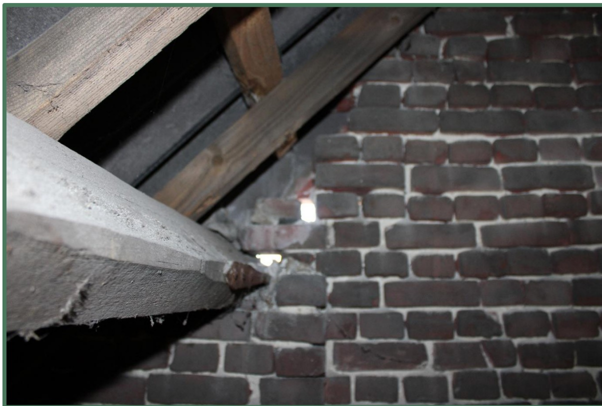
Foto 56: Gat in westelijke kopgevel bijgebouw nr. 126, vanaf binnenzijde.
