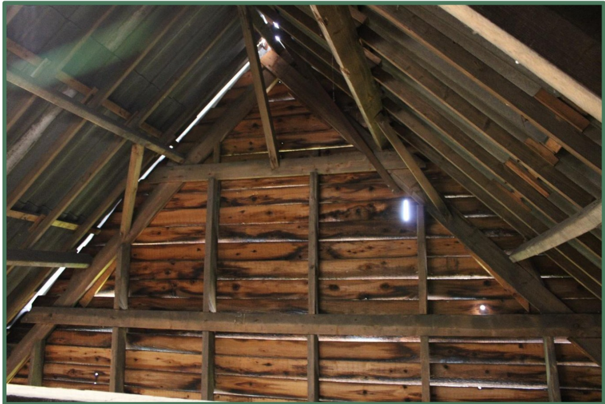
Foto 52: Kieren in oostelijke kopgevel bijgebouw nr. 126, vanaf binnenzijde.
