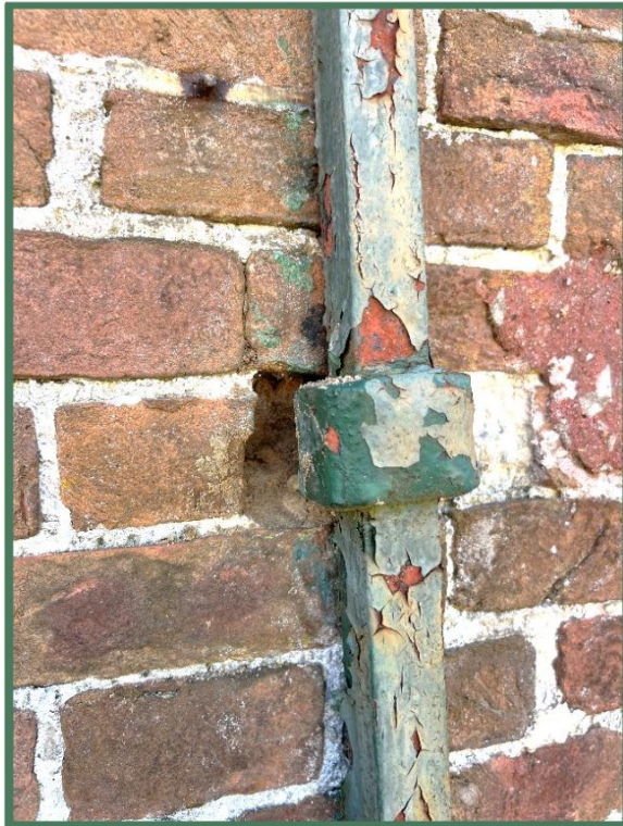
Foto 33 + 34: Ondiepe voegschade langs muuranker.
