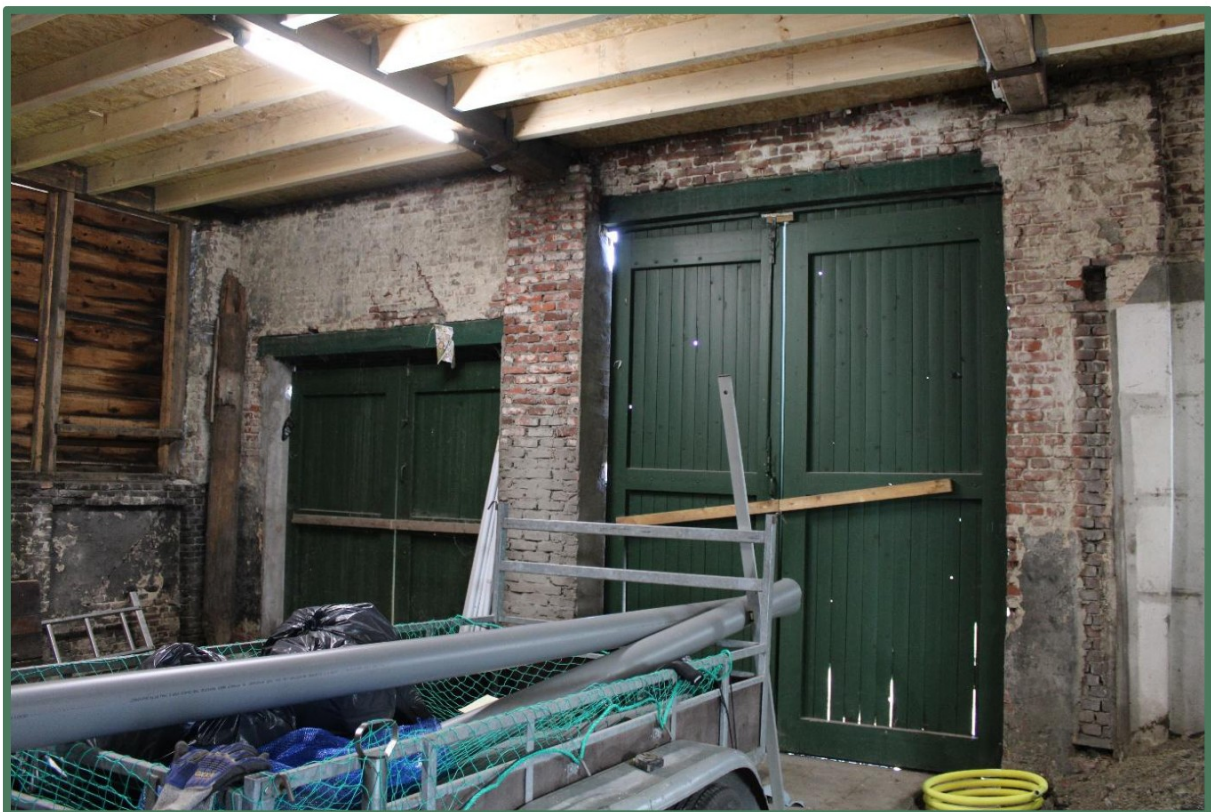
Foto 54: Kieren in buitengevels bijgebouw nr. 126, vanaf binnenzijde.
