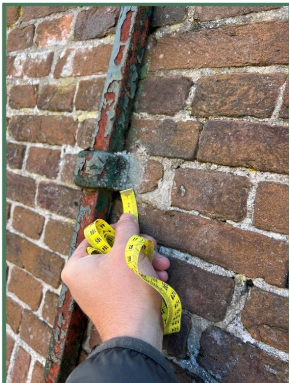
Foto 35 + 36: Ondiepe voegschade langs muuranker.
