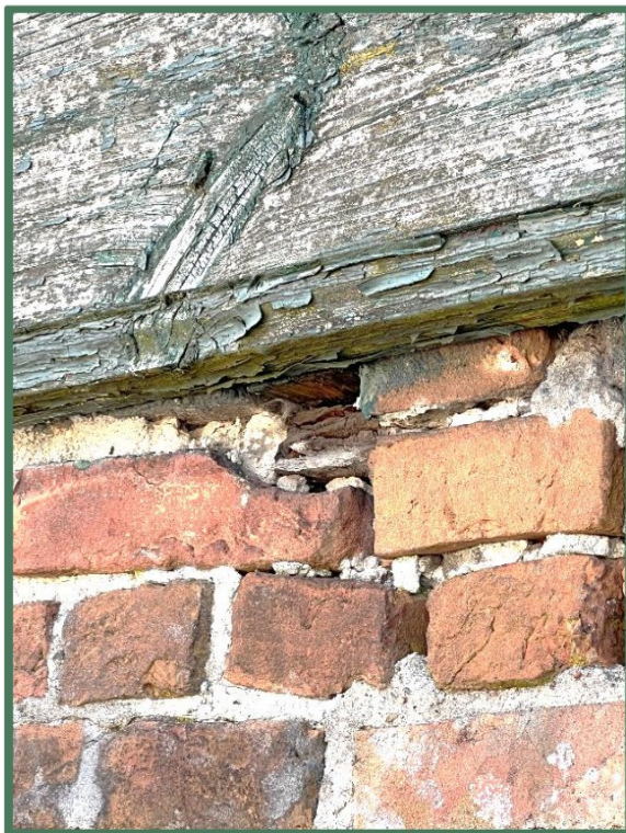
Foto 32: Voegschade bedrijfspand Herelsestraat 124, zonder geschikte tussenruimte voor vleermuizen.
