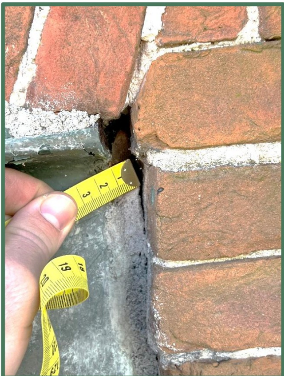
Foto 48: Detailfoto ondiep gat in rechterbovenhoek dorpel voordeur bedrijfspand.
