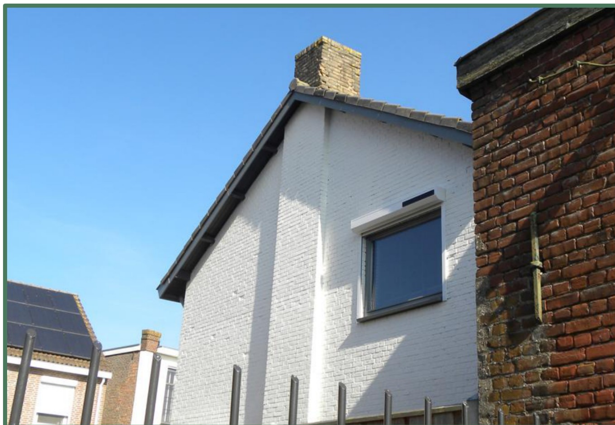
Foto 68: Strak aangesloten kantpannen op glad boeiboord zuidelijke gevel woning aan Herelsestraat 126.
