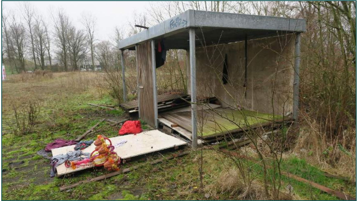
Figuur 3 Op het braakliggend terrein is nog een overkapping aanwezig die gesloopt wordt in de beoogde ontwikkeling.
