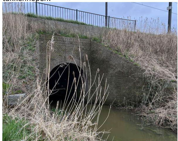
Figuur 12. De onderdoorgang van de Smalle Beek onder de spoorlijn door, aan de oostkant van het bosje.
