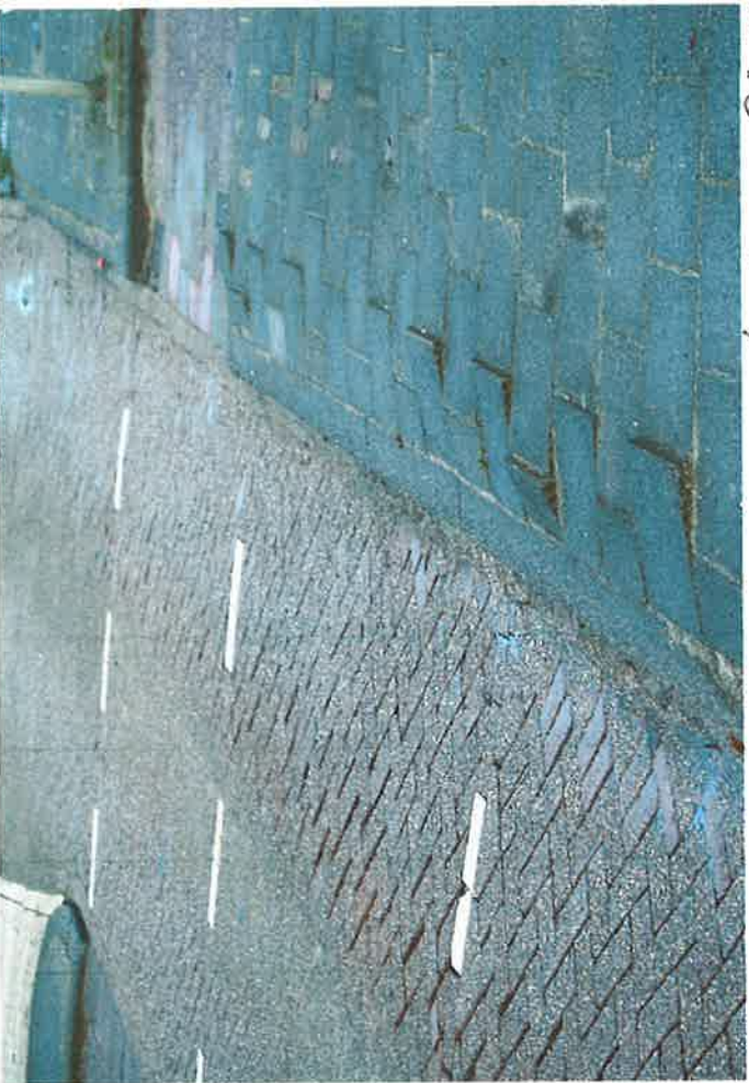
Het onlangs gerepareerde trottoir t.h.v. huisno. 97-99. Na enkele dagen weer in deze staat.
