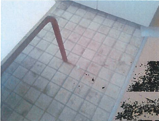
Scheuren niet constructief
