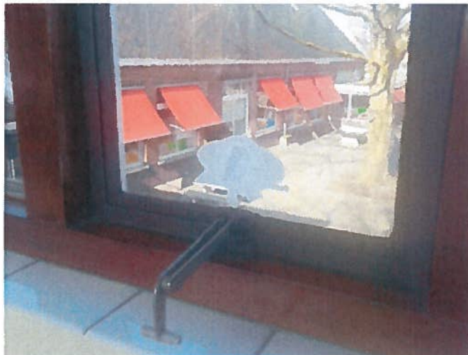
Corrosie (verzinkt) stalen kozijnwerk
